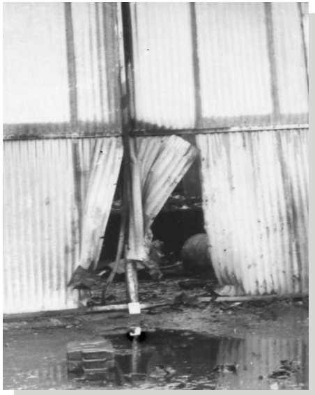
Locaux des services techniques après l'explosion d'une bombe
